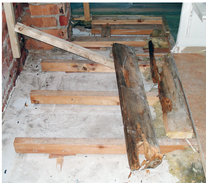
Fukt-/rötskador förekommer också i byggnader som ska åtgärdas mot radongasbelastning.
