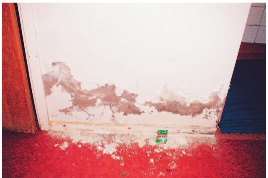
Fuktrelaterad skada i vägg nära våtrum.
