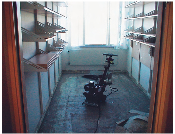
Nedbrutet mattlim måste slipas bort först oavsett saneringsmetod.
