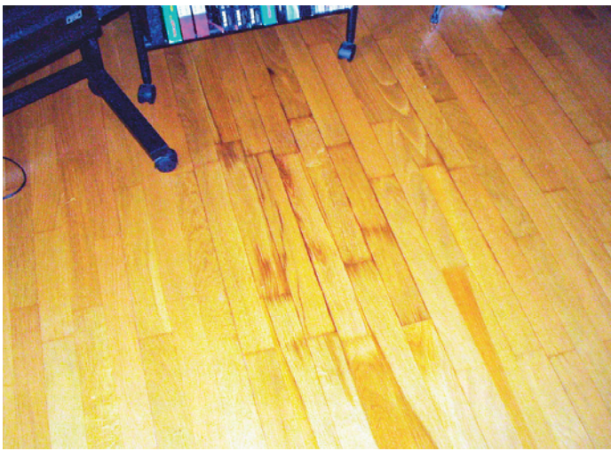
Svartning av eklameller i trägolv är ofta ett tecken på att ammoniak producerats vid nedbrytning av kaseinhaltigt flytspackel.
