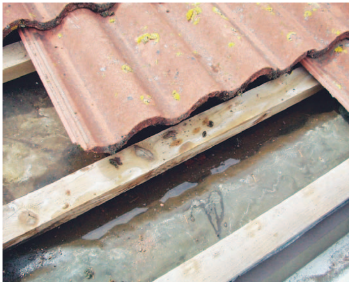
Bild 6: Vatten blir stående kvar på duken ovan takfot.
