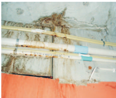
Bild 4: Vattenånga som kondenserat mot den kalla yttre duktäckningen rann tillbaka ner genom otätheter i ångspärren.
