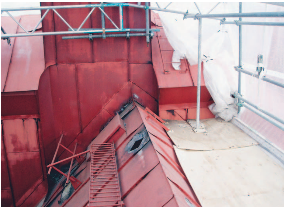
Bild 8: Branden hade bränt upp underlagstak och papp bakom plåten. Hettan brände även sönder färgen på plåten.
