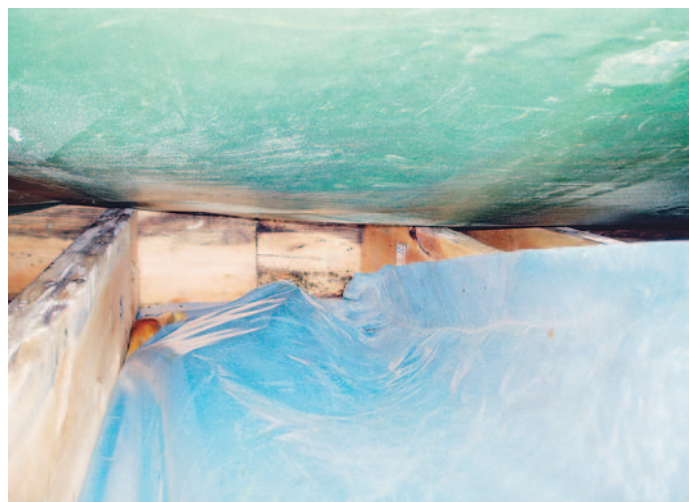
Bild 3: I ytterväggar mot äventyrsbadet fanns mögelpåväxt på väggreglar och hammarband. Angreppen fanns i väggarnas yttre del, där temperaturen var lägst. Bilden är taget uppåt mot hammarbandets undersida bakom den gröna presenningen som var monterad som skydd, där väggens yttre del var riven. Den blå folien är ångspärren.
