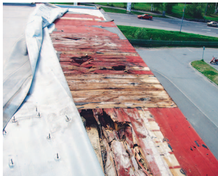
Bild 2: Utmed taksargar över äventyrsbadet fanns underlagstak av trä som ruttnat helt. I den inre delen av taket över äventyrsbadet och i taket över simhallen låg cellplastisolering och en tunn skiva mineralull under duken.
