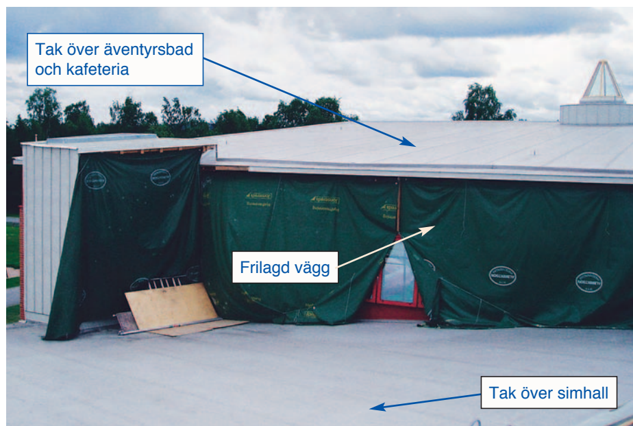
Bild 1: Omfattande skador fanns i väggar och tak, främst vid äventyrsbadet där ånginnehållet i inneluften var högst.
