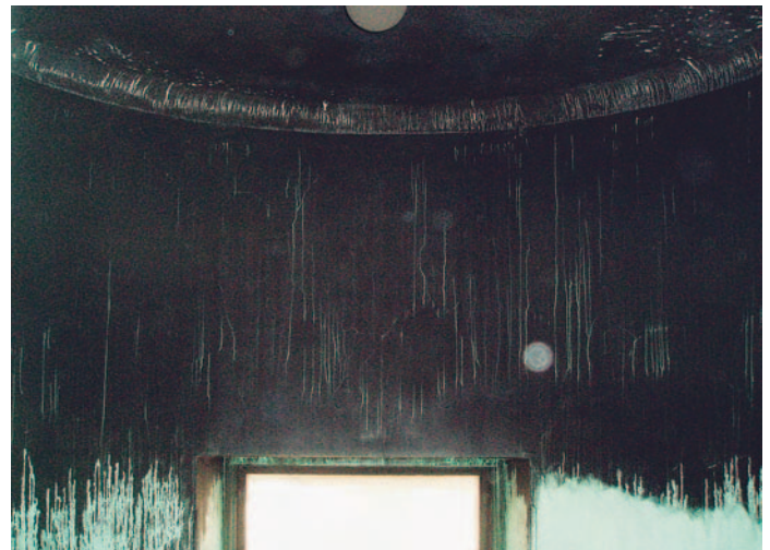
Bild 10: Putsen som luktar måste tas bort, rentvättning av ytan räcker inte. Bilden visar tak och överdel av väggar i ett av trapphusen.
