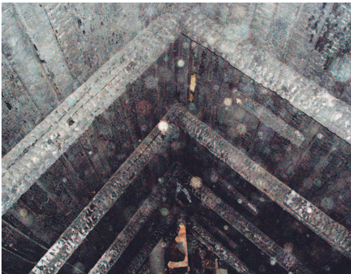
Bild 9: Takstolar och yttertakspanel i båda takfallen var brandskadad mellan två trapphus.
