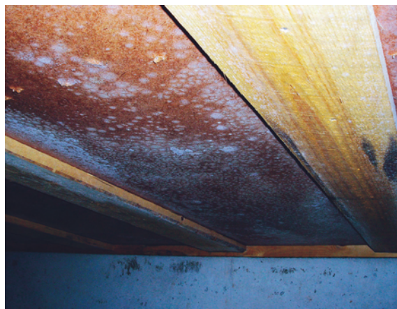
Riklig mögelpåväxt fanns på bjälklagets undersida.
