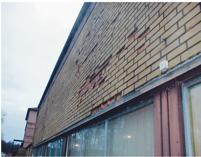
Bild 3: Teglet hade frusit sönder i ytterväggen utanför simhallen, men klarat sig bra där torrare lokaler fanns innanför.
