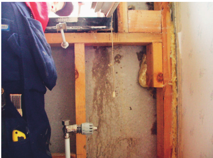
Bild 5: Vatten har sugits in mellan karmsidostycke och karmbottenstycke och runnit ner på fasadelementets insida.
