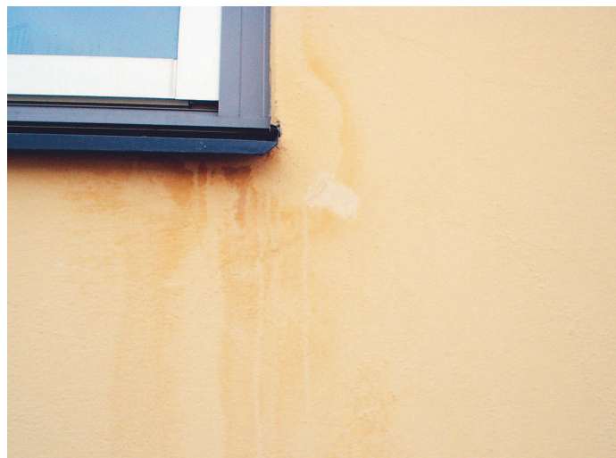
Bild 6: Uttorkning av fukt i väggen vid fönstret lämnade spår i silikatfärgen.
