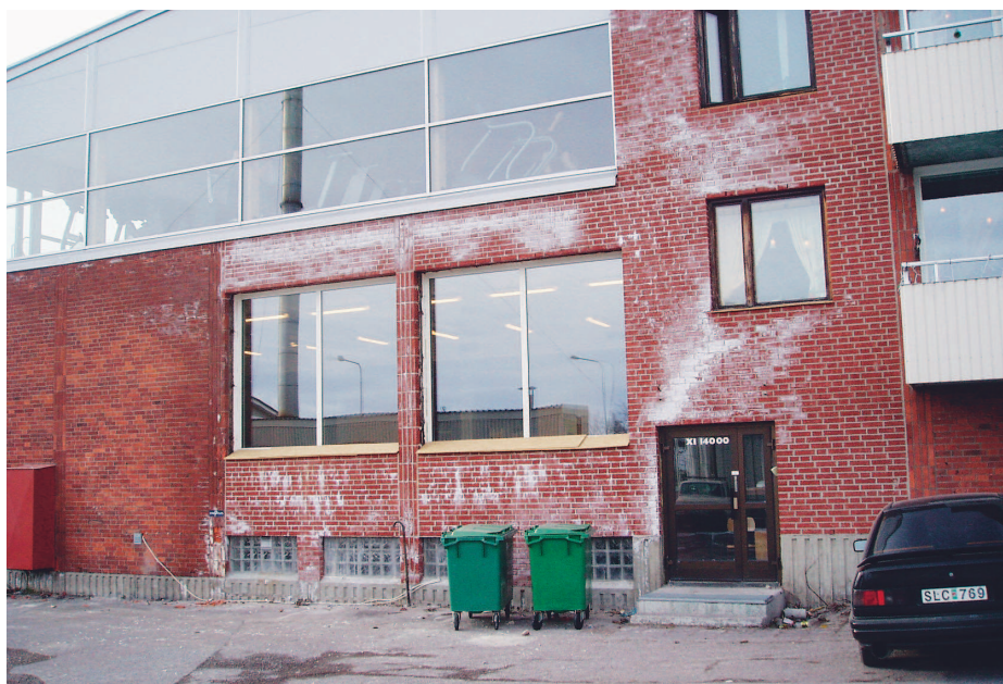
Bild 1: Kombinationen högt ånginnehåll i inneluften och hög innetemperatur (över 30 °C) i ett badhus resulterade i kraftiga kalkutfällningar. Fukten kondenserar mot skalmurens baksida varefter kalken löstes i kondensvattnet och transporteras ut till teglets utsida där det blir kvar när fukten avdunstar till uteluften. Skadorna på bilden berodde på otätheter runt fönstren.
