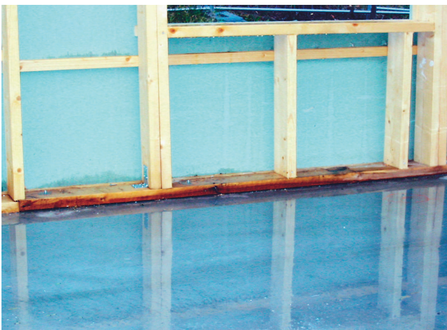
Bild 9: Det tar månader att torka ut en träsyll som ligger på fuktig betong och på den tiden hinner mögel börja växa.
