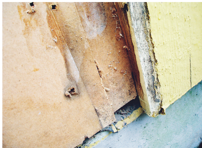
Bild 4: Regnvatten har sugits/runnit in mellan lock- och bottenbräda och orsakat mögelangrepp både på panelbrädor och på bakomliggande vindskydd av masonite (utan luftspalt). Tät målarfärg har även fördröjt uttorkningen.
