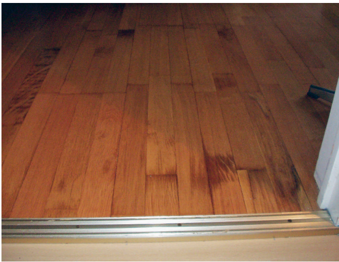
Svärtning ekparkett på grund av kaseinhaltigt flytspackel under.
