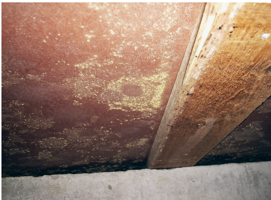
Mögelpåväxt på blindbotten av masonite.
