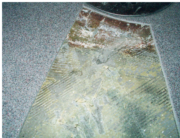
Limnedbrytning orsakad av fukt in under mattan vid golvbrunn.
