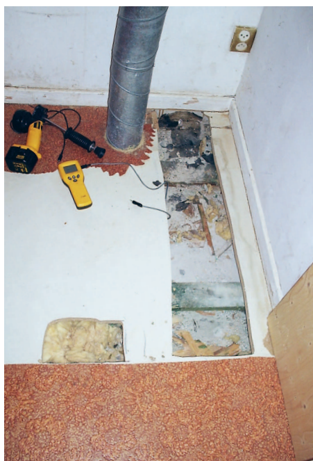
Uppreglat golv med trä direkt på betongplattan och kvarlämnat byggspill.
