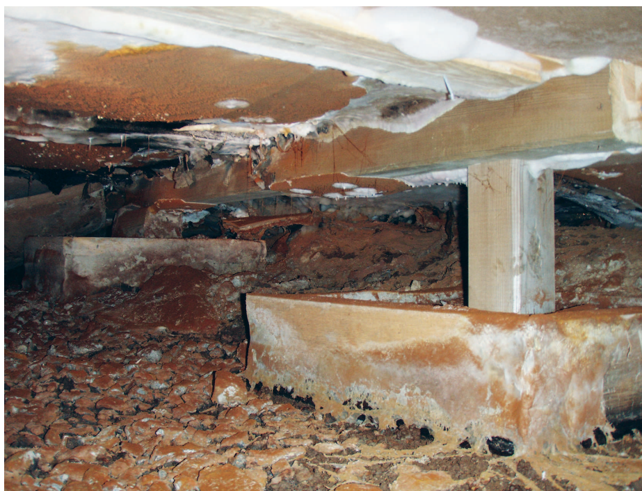
Krypgrund med angrepp av äkta hussvamp.
